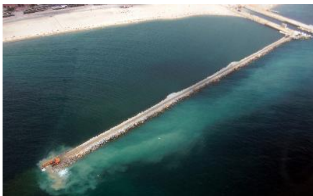
Decoloració provocada pels treballs de construcció de l'espigó a la platja del Bogatell, a Barcelona (23-08-2010)
