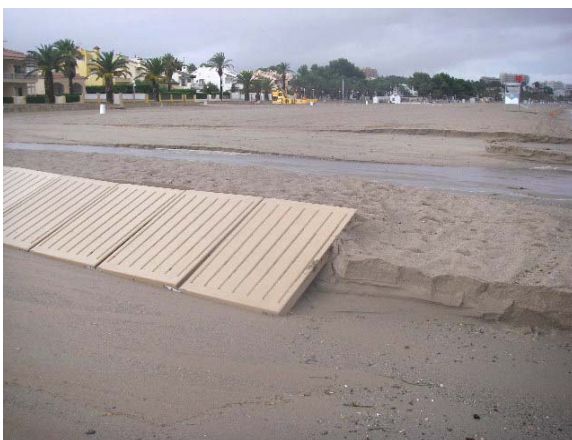
Passarel·la en mal estat a la platja del Cristall, a Mont-roig del Camp (19-08-2010)
