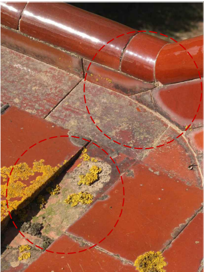
V7. Presència de líquens. Degradació i brutícia de les peces ceràmiques vitrificades. Font: GAA. 25/09/2018
