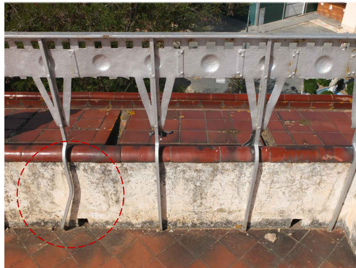
V10. Presència d'òxid en l'ancoratge de la barana metàl·lica i amb deformacions puntals. Font: GAA. 25/09/2018
