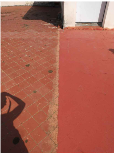
V9. Vista de tela asfàltica sobre una part del paviment. Font: GAA. 25/09/2018
