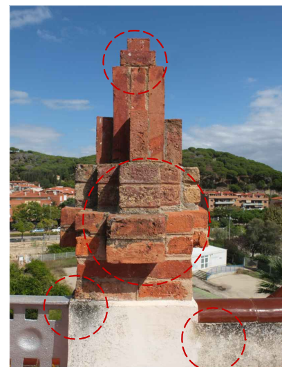
V7. Presència de líquens en paraments verticals Font: GAA. 25/09/2018
