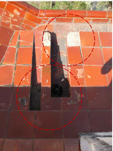
V9. Degradació i despreniment de peces ceràmiques vitrificades. Font: GAA. 25/09/2018
