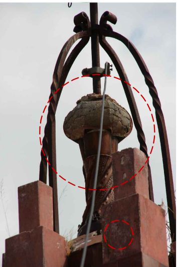
V3. Taques d'humitat i despeniment del revestiment. Font: GAA. 25/09/2018
