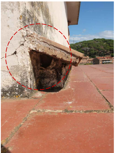
V10. Degradació del revestiment. Fissures en paraments verticals. Font: GAA. 25/09/2018
