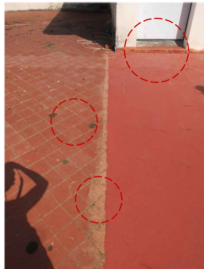
V12. Presència de líquens i brutícia a l'enrajolat ceràmic. Degradació de la tela asfàltica. Font: GAA. 25/09/2018
