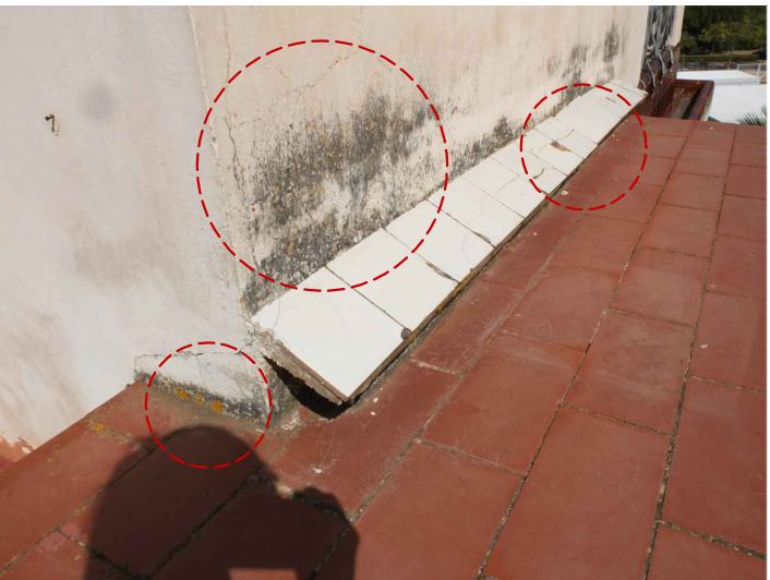
V11. Degradació del revestiment. Fissures en paraments verticals i presència d'humitat. Rajoles ceràmiques del minvell trencades i fissurades. Font: GAA. 25/09/2018
