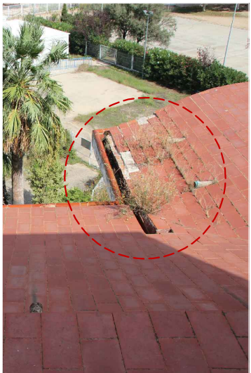
V2. Manca de peces ceràmiques, filtració d'aigua i proliferació de plantes. Font: GAA. 25/09/2018
