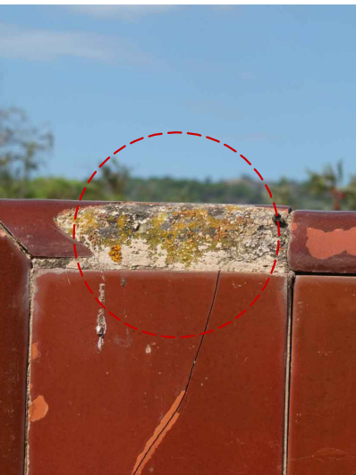
V13. Respiradors de tub circular en mal estat. Líquens a la trobada amb la coberta. Font: GAA. 25/09/2018
