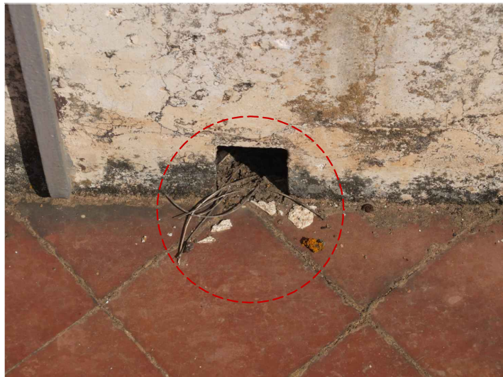
V8. Acumulació de brutícia als embornals, obstruint l'orifici que evacua l'aigua. Font: GAA. 25/09/2018
