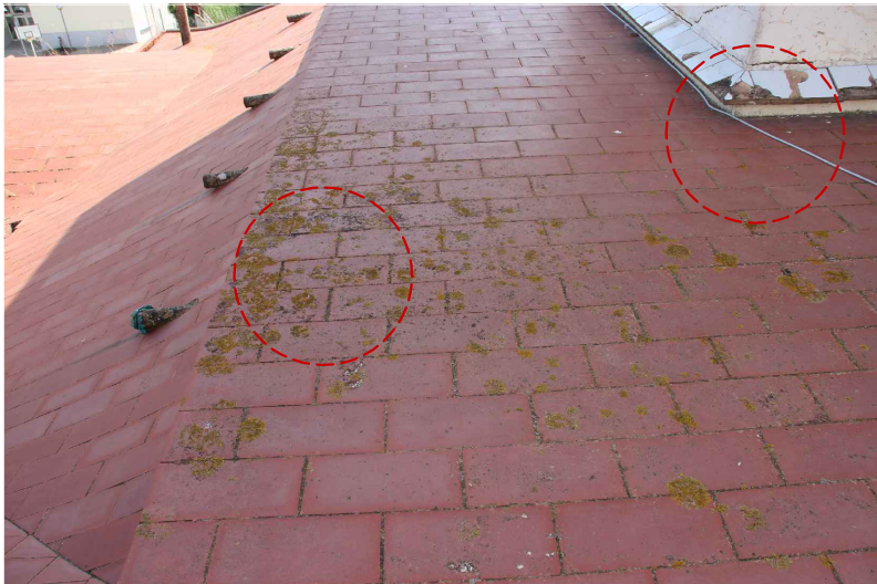
V6. Degradació de les juntes i presència generalitzada d'eflorescència i líquens a les juntes i a la superfície. Rajoles ceràmiques vitrificades del minvell trencades i fissurades. Font: GAA. 25/09/2018
