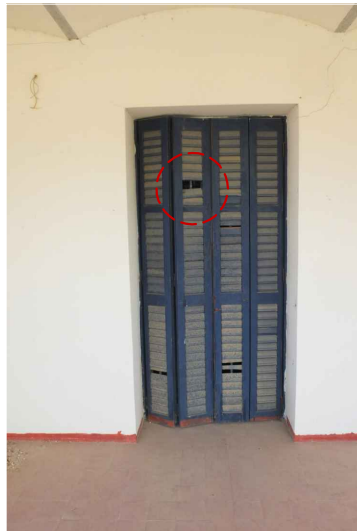
V5. Degradació de la carpinteria original de la porta d'accés al porxo. Font: GAA. 25/09/2018
