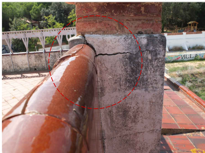
V4. Parament vertical d'obra amb esquerdes superficials. Presència d'humitats. Degradació i brutícia superficial. Font: GAA. 25/09/2018
