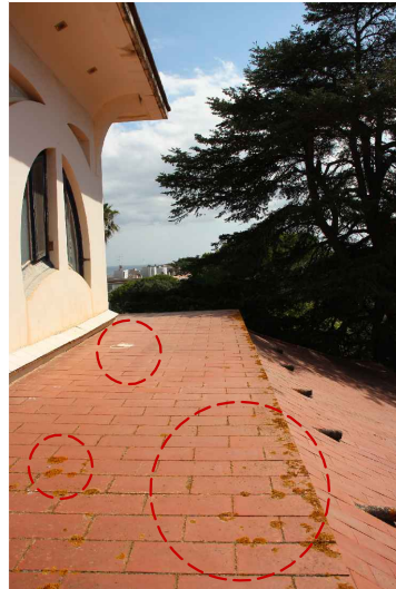
V9. Degradació de les juntes i presència de líquens al paviment. Font: GAA. 25/09/2018
