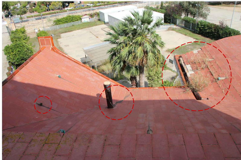
V3. Degradació del revestiment de peces ceràmiques de la coberta en la trobada amb elements sortints. Taques d'humitat i brutícia. Manca de peces, filtració d'aigua i proliferació de plantes. Font: GAA. 25/09/2018
