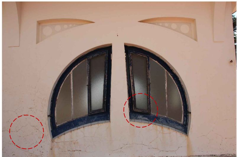
V9. Degradació de la fusteria original. Degradació del revestiment. Fissures superficials en paraments verticals i taques d'humitat. Font: GAA. 25/09/2018
