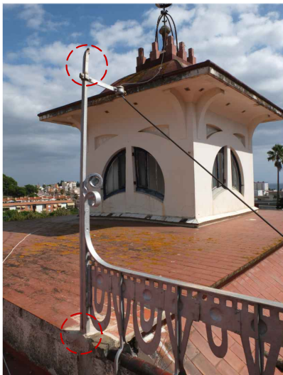
V2. Punts d'ancoratge del muntant al parament d'obra en mal estat. Oxidació metall. Font: GAA. 25/09/2018
