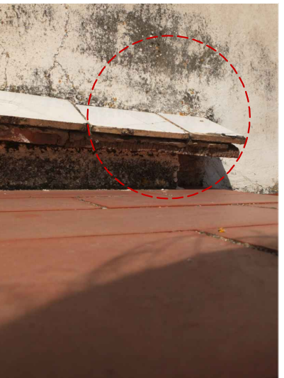
V12. Degradació del revestiment. Fissures superficials i presència d'humitats. Font: GAA. 25/09/2018
