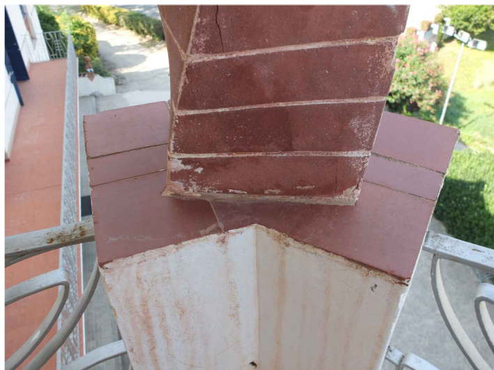
V8. Detall inferior de la columna salomònica de maó ceràmic, sobre base de mur d'obra, que suporta l'estructura de la coberta del porxada. Font: GAA. 25/09/2018
