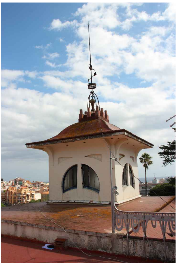
V3. Diferència de cota entre cobertes. Façanes nord-oest i sud-oest. Font: GAA. 25/09/2018
