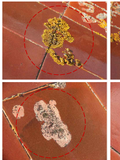
V11. Presència de líquens i degradació de les peces ceràmiques vitrificades en la seva superfície i en les juntes. Font: GAA. 25/09/2018
