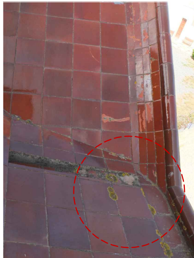
V4. Presència de líquens i degradació de les peces ceràmiques vitrificades Font: GAA. 25/09/2018
