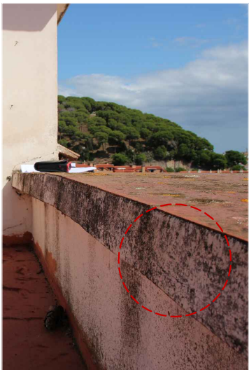
V4. Degradació del revestiment, taques de brutícia i d'humitat. Font: GAA. 25/09/2018
