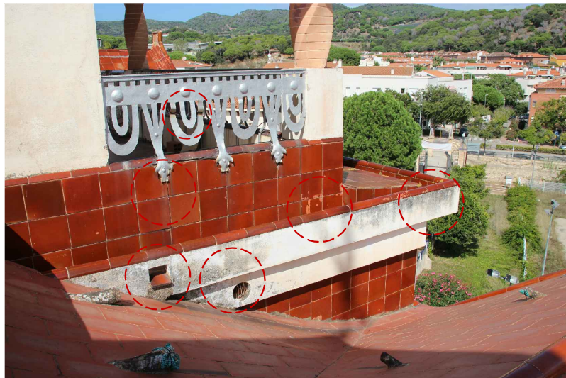
V1. Taques de brutícia i humitat a tot el perímetre del cantell del forjat del cornisament del sector B. Òxid en elements metàl·lics. Font: GAA. 25/09/2018
