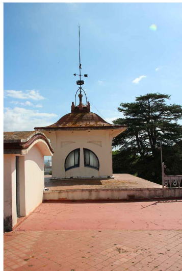
V1. Vista nord-oest de la torre. Font: GAA. 25/09/2018
