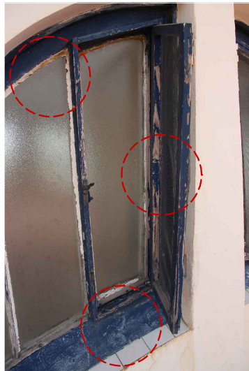
V5. Degradació de la fusteria original. Font: GAA. 25/09/2018
