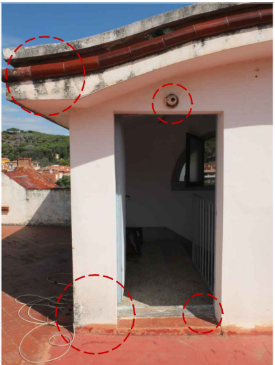
V6. Degradació del revestiment, brutícia i taques d'humitat. Font: GAA. 25/09/2018
