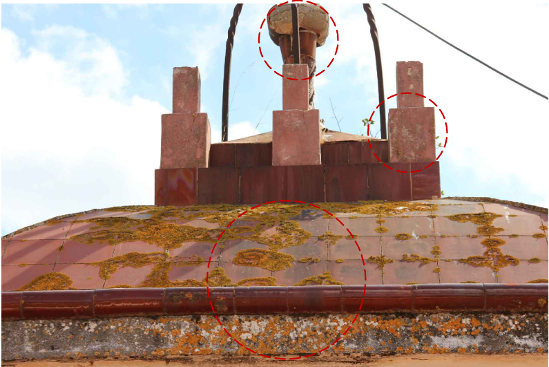
V4. Presència generalitzada d'eflorescència i líquens a les juntes i a la superfície de les peces ceràmiques de la coberta de la torre. Despeniment del revestiment i brutícia superficial dels paraments. Font: GAA. 25/09/2018
