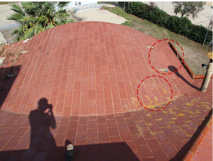
V4. Degradació del revestiment de peces ceràmiques de la coberta enel canvi de rasant. Peces de la canal malmeses, filtració d'aigua i proliferació de plantes. Font: GAA. 25/09/2018
