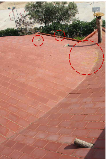
V3. Presència de líquens a les juntes i a la superfície del revestiment. Font: GAA. 25/09/2018
