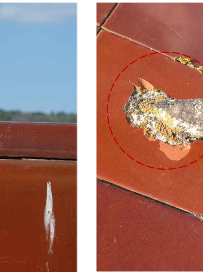
V14. Presència d'humitats i despreniment del revestiment. Font: GAA. 25/09/2018
