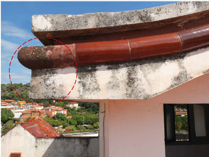
V5. Degradació del revestiment i de les peces ceràmiques vitrificades de la cornisa de la coberta del badalot. Presència de líquens, taques de brutícia i d'humitat. Font: GAA. 25/09/2018
