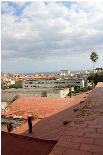
V8. Trobada entre la coberta plana i la inclinada de l'entorn de la torre. Font: GAA. 25/09/2018
