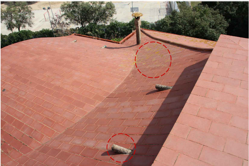
V4. Degradació de les juntes i presència de líquens a la superfície del revestiment de peces ceràmiques. Respiradors de tub circular en mal estat. Font: GAA. 25/09/2018
