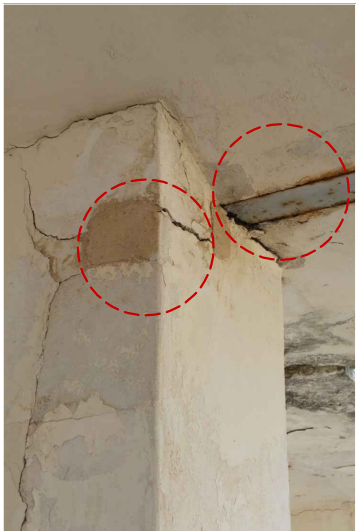
V6. Presència d'humitats a la part inferior del forjat. Bigues oxidades. Font: GAA. 25/09/2018
