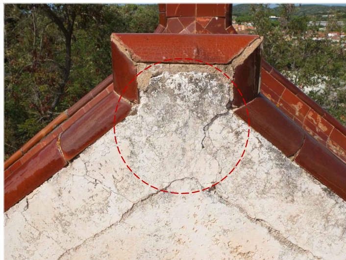
V6. Fissures en parament vertical. Presència d'humitats. Degradació i brutícia superficial. Font: GAA. 25/09/2018
