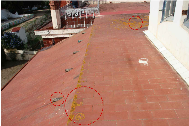
V10. Degradació de les juntes i presència de líquens al paviment de rajola ceràmica en el canvi de rasant de la coberta. Respiradors de tub circular en mal estat. Taques d'humitat i brutícia. Font: GAA. 25/09/2018
