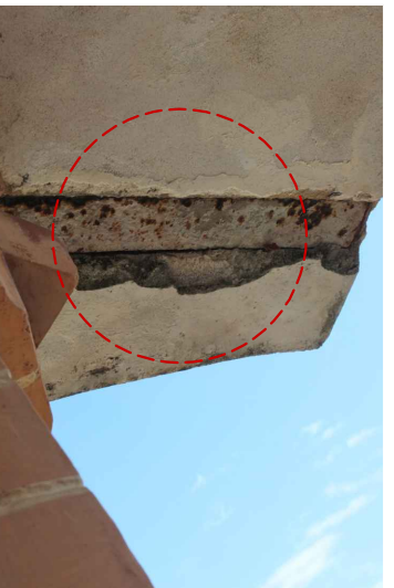
V14. Degradació del forjat. Bigues oxidades. Despreniments de material. Font: GAA. 25/09/2018
