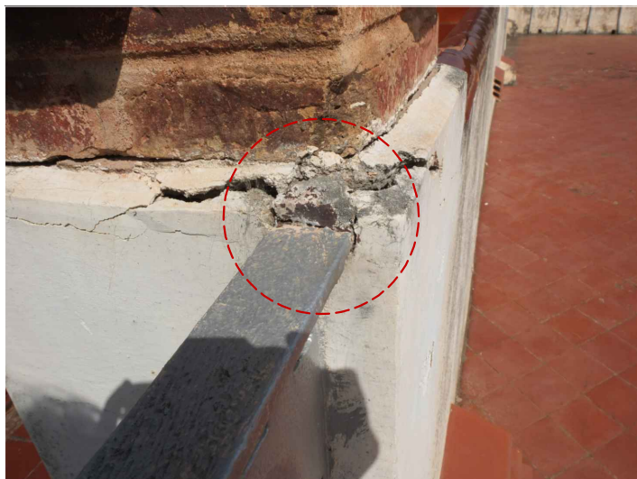
V5. Esquerdes en els punts d'ancoratge dels travessers al parament d'obra per l'oxidació de l'acer i/o dilatació del material. Font: GAA. 25/09/2018
