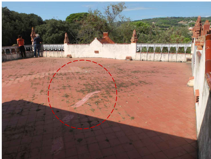
V2. Degradació de les juntes i presència generalitzada d'eflorescència i líquens a les juntes i a la superfície del paviment. Font: GAA. 25/09/2018
