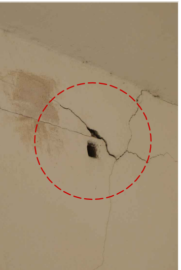
V7. Fissures i esquerdes superficials en paraments verticals. Font: GAA. 25/09/2018
