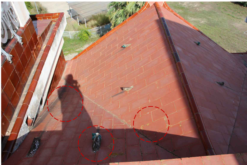
V2. Degradació de les juntes i presència de líquens a les juntes i a la superfície del revestiment de peces ceràmiques. Respiradors de tub circular en mal estat. Taques d'humitat i brutícia. Font: GAA. 25/09/2018
