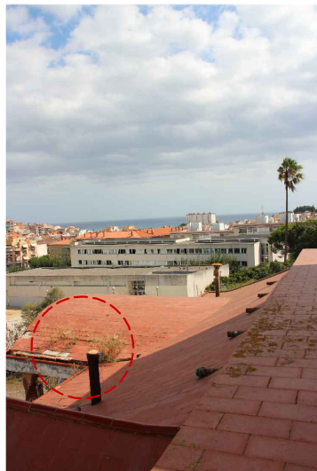
V1. Manca de peces ceràmiques, filtració d'aigua i proliferació de plantes. Font: GAA. 25/09/2018
