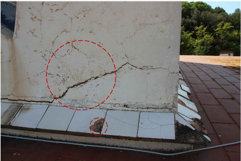
V8. Degradació del revestiment. Fissures superficials en paraments verticals i taques d'humitat. Rajoles ceràmiques vitrificades del minvell trencades i fissurades. Font: GAA. 25/09/2018
