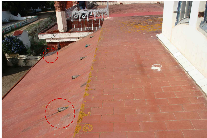
V5. Degradació de les juntes i presència de líquens al paviment de rajola ceràmica en el canvi de rasant de la coberta. Respiradors de tub circular en mal estat. Taques d'humitat i brutícia. Font: GAA. 25/09/2018
