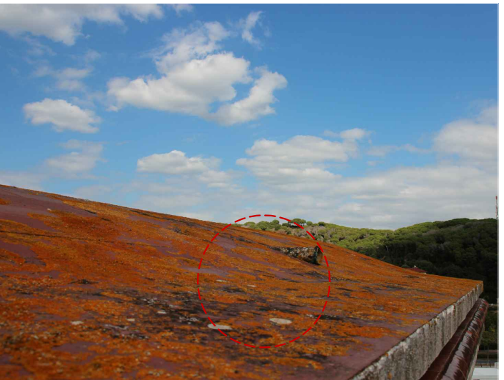
V13. Presència generalitzada d'eflorescència i líquens a les juntes i a la superfície de la coberta del badalot d'escala. Font: GAA. 25/09/2018
