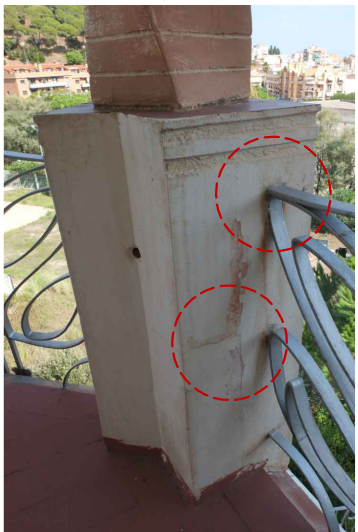
V11. Despreniment de material. Òxid del metall en punts d'ancoratge. Font: GAA. 25/09/2018
