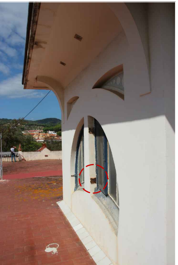
V7. Degradació de la fusteria original. Òxid en elements metàl·lics. Font: GAA. 25/09/2018
