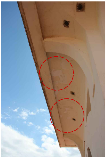
V6. Taques d'humitat i despeniment del revestiment. Font: GAA. 25/09/2018
