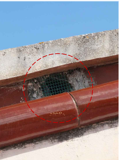
V7. Presència d'humitat en orificis de ventilació Font: GAA. 25/09/2018
