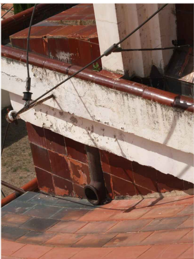
V12. Sortida d'aigües pluvials de la coberta plana cap a la canal del ràfec perimetral. Font: GAA. 25/09/2018
