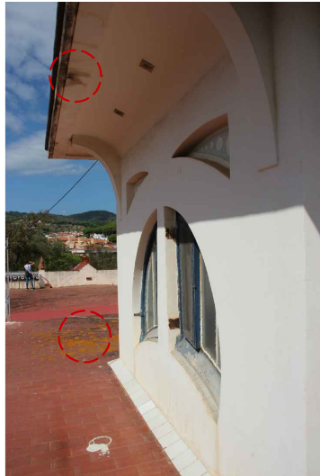
V11. Taques d'humitat en el forjat de coberta de la torre. Font: GAA. 25/09/2018
