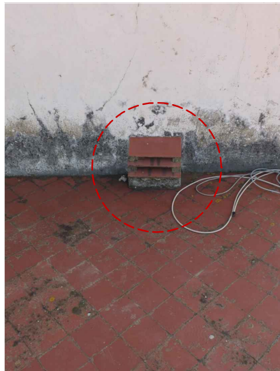
V4. Degradació del revestiment, brutícia i taques d'humitat. Font: GAA. 25/09/2018
