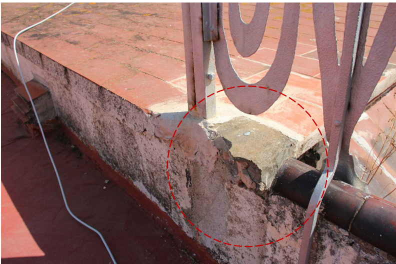
V3. Punts d'ancoratge del muntant al parament d'obra en mal estat. Oxidació de l'acer de les baranes de fosa. Degradació del revestiment del cantell del forjat, taques de brutícia i d'humitat. Font: GAA. 25/09/2018
