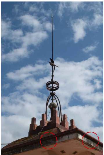
V2. Degradació del revestiment del cantell del forjat. Taques d'humitat. Font: GAA. 25/09/2018
