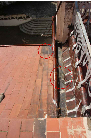
V7. Peces de la canal malmeses, filtració d'aigua i proliferació de vegetació. Font: GAA. 25/09/2018
