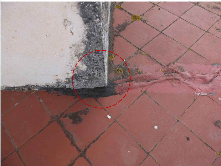
V3. Presència de líquens. Degradació del revestiment en paraments verticals, amb brutícia i taques d'humitat. Font: GAA. 25/09/2018
