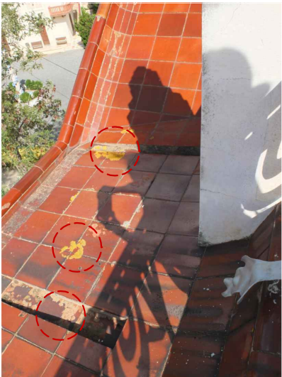
V6. Presència de líquens. Degradació i brutícia de les peces ceràmiques vitrificades. Font: GAA. 25/09/2018
