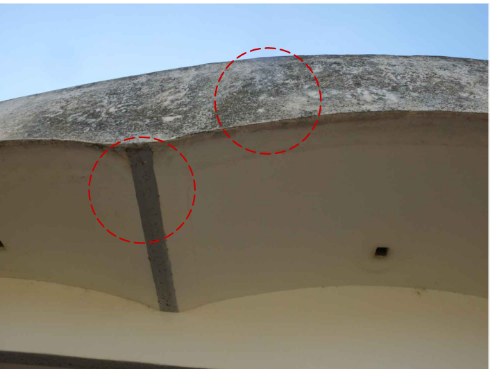
V12. Presència d'humitats al cantell del forjat. Taques d'humitat i brutícia. Bigues metàl·liques oxidades, augment de volum i degradació del forjat. Font: GAA. 25/09/2018
