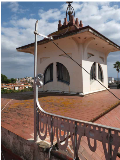
V2. Diferència de cota entre cobertes. Façanes nord-oest i sud-oest. Font: GAA. 25/09/2018
