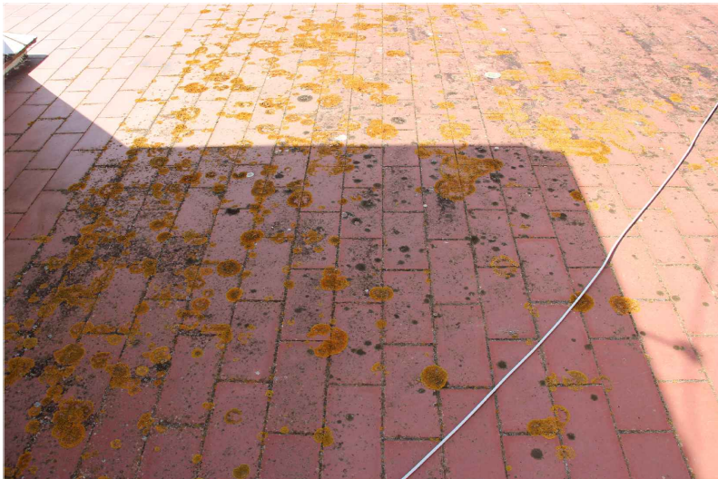
V7. Degradació de les juntes i presència generalitzada d'eflorescència i líquens a les juntes i a la superfície del paviment de rajola ceràmica. Taques de brutícia i d'humitat. Font: GAA. 25/09/2018
