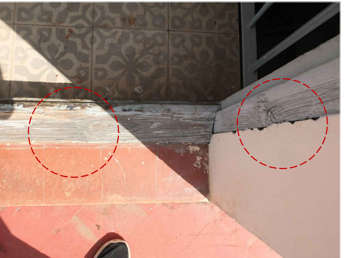
V8. Degradació de la fusteria de la porta d'accés al badalot d'escala. Taques d'humitat. Font: GAA. 25/09/2018
