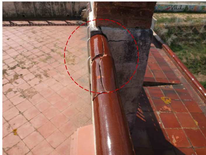
V3. Trencament de peces ceràmiques vitrificades de coronació. Font: GAA. 25/09/2018
