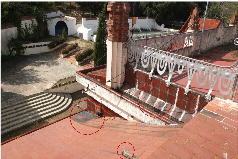
V6. Degradació del revestiment de peces ceràmiques de la coberta. Taques d'humitat i brutícia. Peces malmeses, filtració d'aigua i proliferació de plantes. Respiradors de tub circular en mal estat. Font: GAA. 25/09/2018
