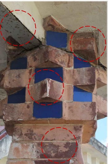
V8. Degradació de les peces del capitell. Taques humitat i bigues oxidades. Font: GAA. 25/09/2018
