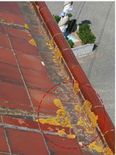
V8. Presència de líquens. Degradació i brutícia de les peces ceràmiques vitrificades. Font: GAA. 25/09/2018
