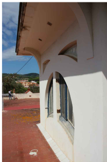
V9. Detall de mènsules de suport del voladís de la coberta. Font: GAA. 25/09/2018
