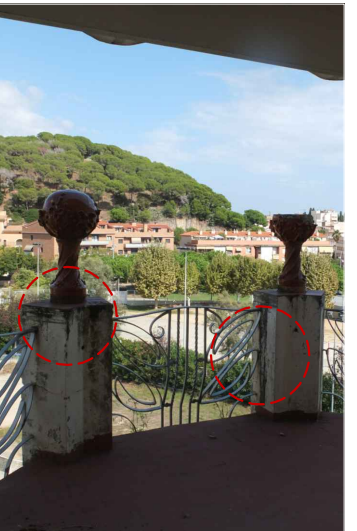
V9. Degradació del revestiment. Taques d'humitat i brutícia. Font: GAA. 25/09/2018
