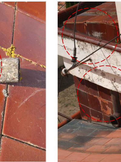
V15. Presència d'humitats i despreniment del revestiment. Font: GAA. 25/09/2018
