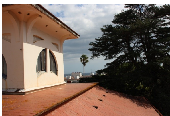
SECTOR F. Coberta inclinada (entorn torre). Font: GAA 25/09/2018
