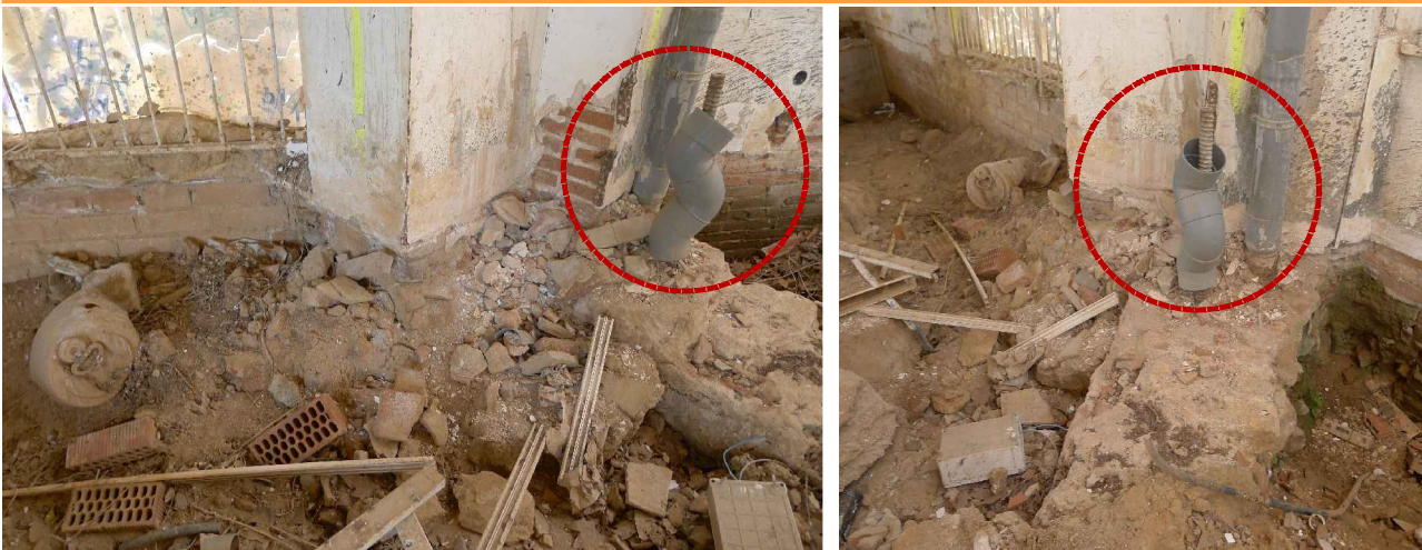
V22-23. Imatges de la base del pilar 26. S'observa algun armat dels micropilotis (sobresortint). Impossible observar l'existència o estat de la fonamentació existent. Font: Arxiu GAA. Data: 14/02/2014.
