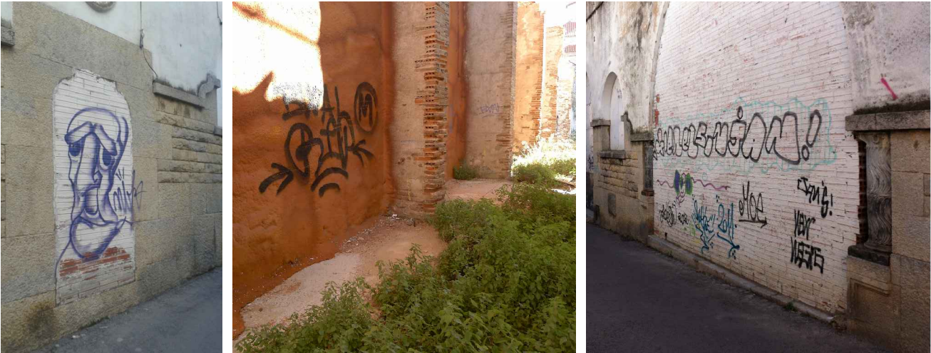
V05-06. Imatges de l'acció antròpica sobre una porta tapiada al carrer Gram, i sobre la mitgera de llevant, a l'àmbit de la porxada. Font: Arxiu GAA. Data: 14/02/2014.
