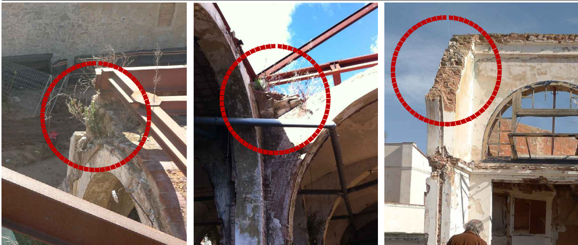
V03-04-05. Imatges de falta d'elements ceràmics en murs i voltes. Font: Arxiu GAA. Data: 14/02/2014.
