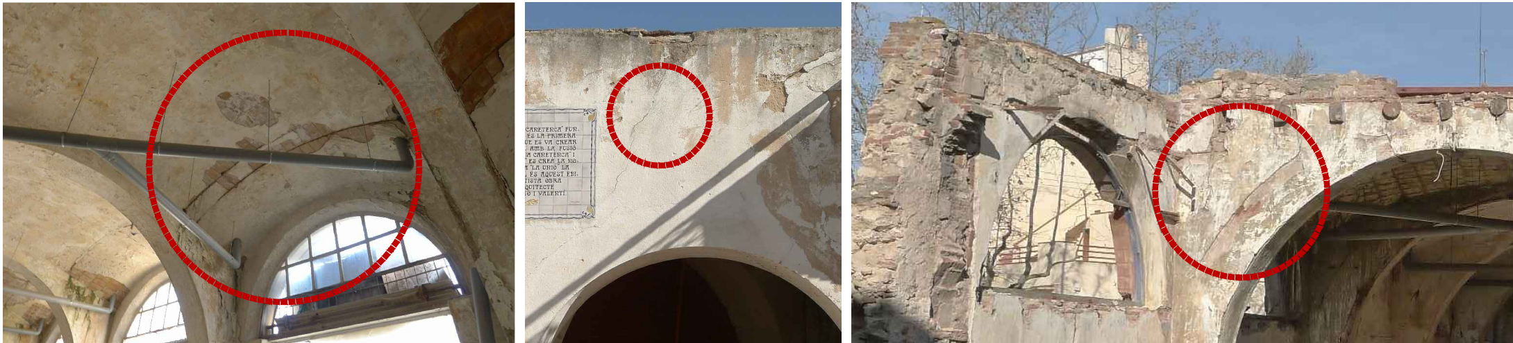
V01-02. Imatges d'una esquerra a l'intradós de les voltes de l'àmbit de la porxada. Fissures a la façana de ponent del teatre Odèon. Font: Arxiu GAA. Data: 14/02/2014. V03. Imatges d'algunes fissures a la l'alçat de migdia, als paraments verticals i seguint la geometria de l'arc A8. Font: Arxiu GAA. Data: 14/02/2014.
