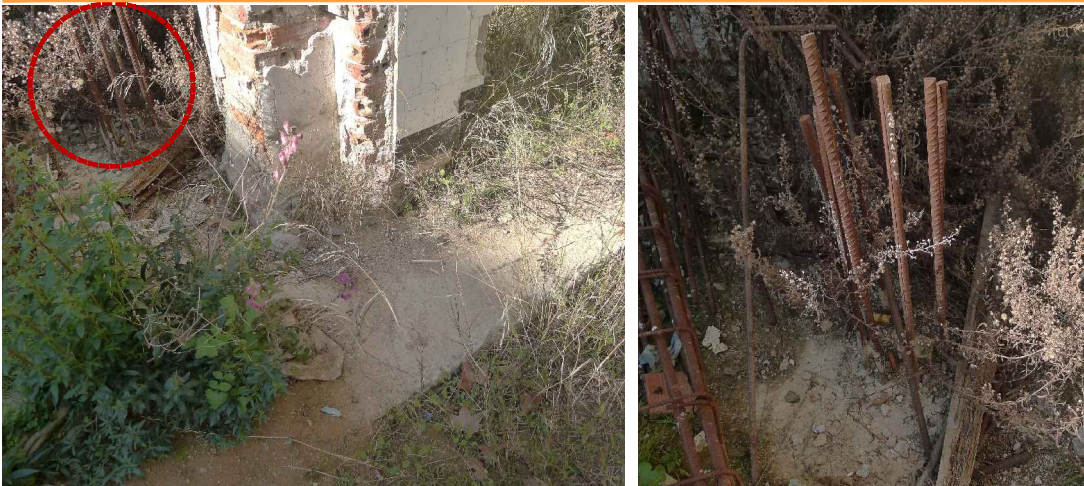
V17-18. Imatges de la base del pilar 22. S'observa la fonamentació executada, amb l'encepat ja formigonat. Es veu l'armat, sobresortint. Pendent de revisió de l'existència i/o estat de tensors i armat segons projecte. Font: Arxiu GAA. Data: 14/02/2014.
