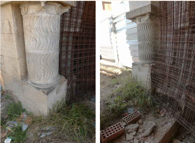
V01-02. Imatges de la base del pilar en cantonada (F01). Impossible observar l'existència o estat de la fonamentació existent. Font: Arxiu GAA. Data: 14/02/2014.
