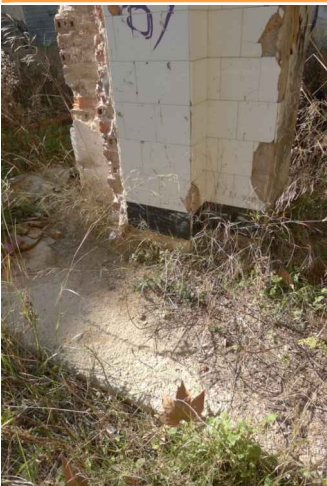
V16. Imatges del pilar 21. Impossible observar l'existència o estat de la fonamentació existent. Font: Arxiu GAA. Data: 14/02/2014.
