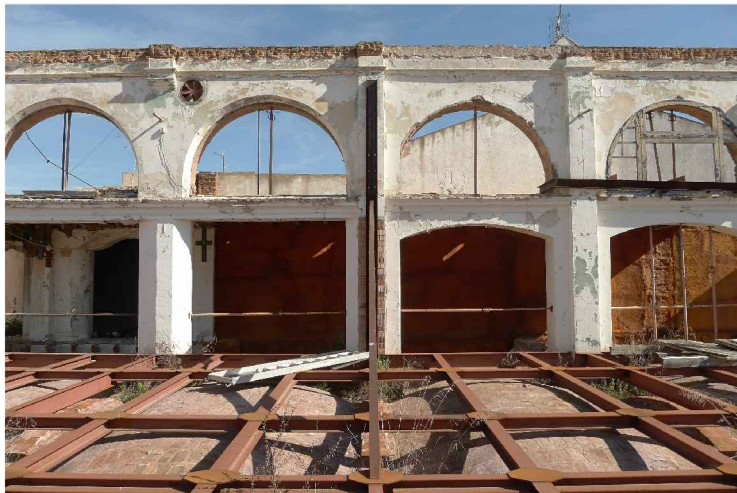
V06. Imatge de l'extradós de les voltes (espai 2.2), amb la façana de llevant apuntalada. S'observen restes de carpinteries degradades. Font: Arxiu GAA. Data: 14/02/2014.
