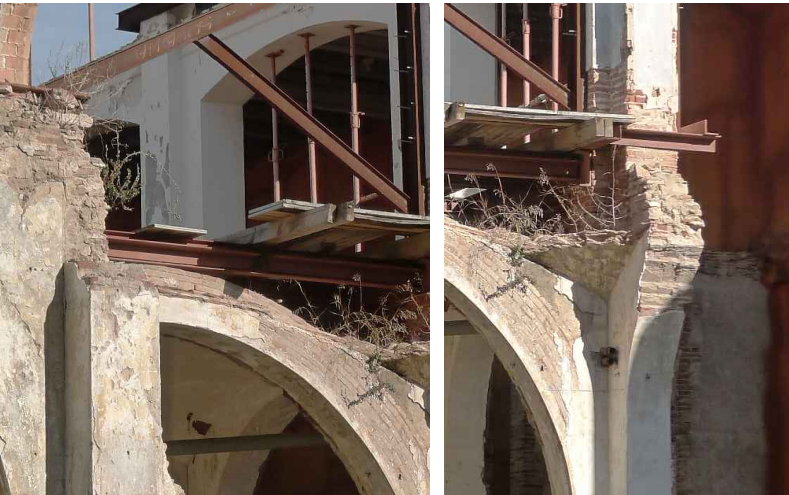
V03-04. Imatges de la falta d'elements ceràmics als paraments i arcs de la façana de migdia, just on es va esfondrar una volta de l'edifici. Font: Arxiu GAA. Data: 14/02/2014.
