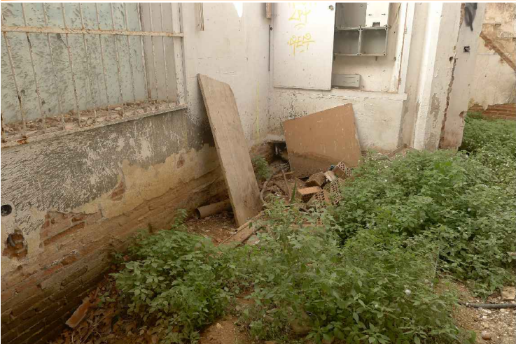
V08. Imatges de la base del mur de façana (F34). Impossible observar l'existència o estat de la fonamentació existent. Font: Arxiu GAA. Data: 14/02/2014.
