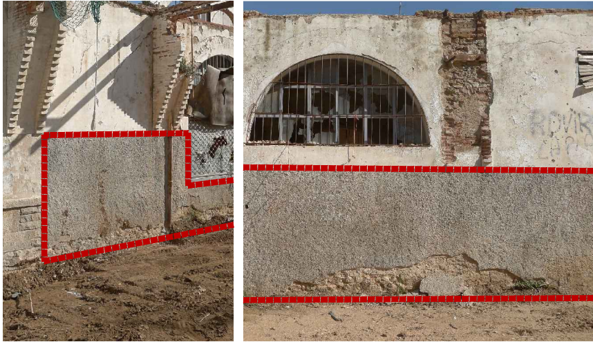
V12-13. Imatges del revestiment disconforme (ciment Pòrtland) a la façana de ponent. Font: Arxiu GAA. Data: 14/02/2014.
