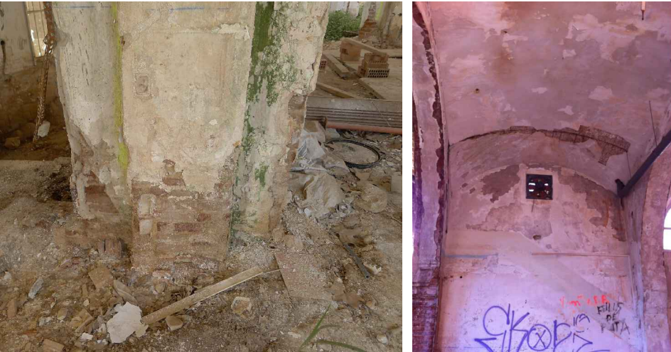
V09. Imatge de la degradació de material a la base d'un dels pilars de l'àmbit de la porxada. Font: Arxiu GAA. Data: 14/02/2014.
