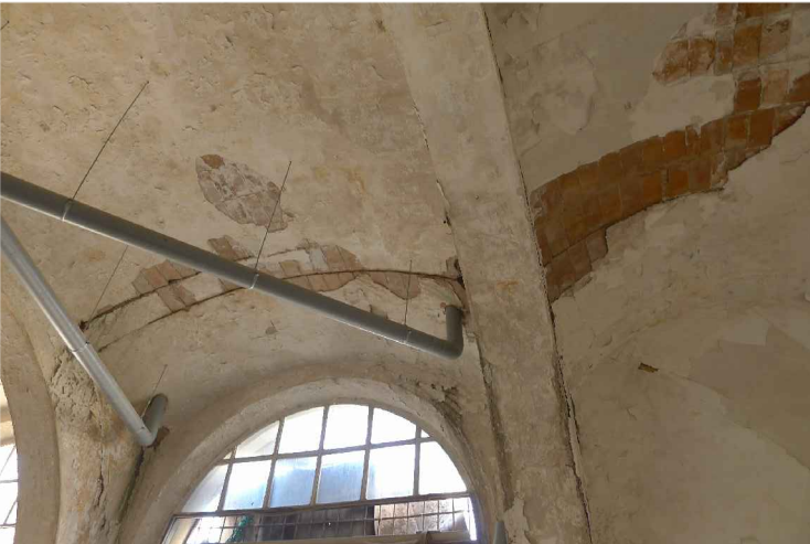
V05. Imatge d'un fragment de sostre del teatre Odéon. S'observa una fissura a les voltes i els canals/baixants provisionals d'aigües pluvials. Font: Arxiu GAA. Data: 14/02/2014.
