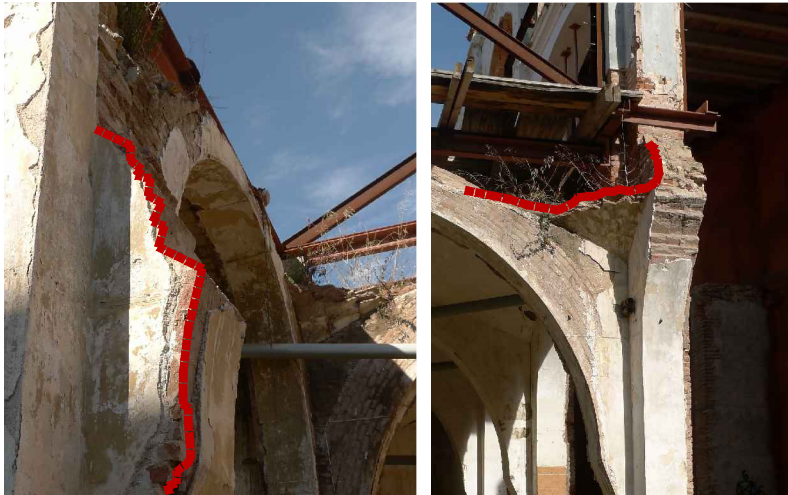
V04-05. Imatges de la falta d'elements ceràmics als murs de la façana de migdia de l'edifici, anteriorment formant els arcs A8-15 i A14-15. Font: Arxiu GAA. Data: 14/02/2014.
