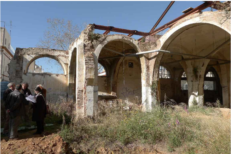
V12. Imatge de l'alçat de migdia, on es va esfondrar una de les voltes de la porxada. Font: Arxiu GAA. Data: 14/02/2014.
