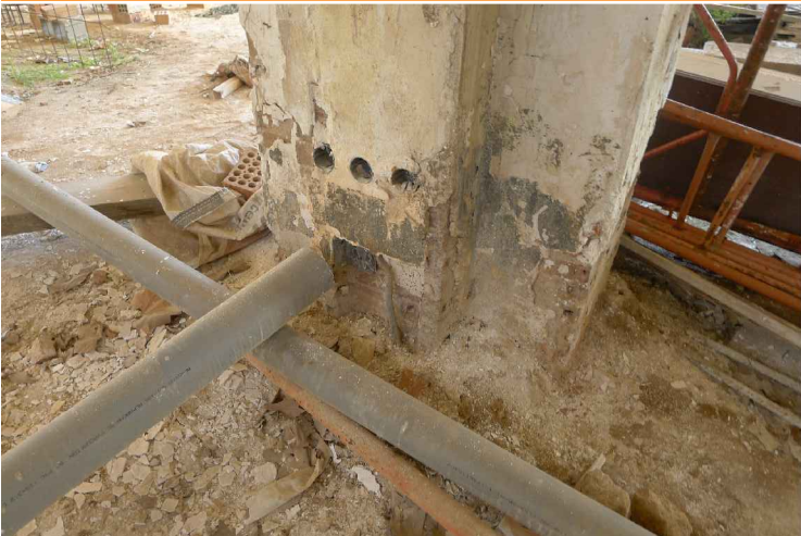
V05. Imatge de la base del pilar 15. Impossible observar l'existència i/o estat de la fonamentació existent. Font: Arxiu GAA. Data: 14/02/2014.
