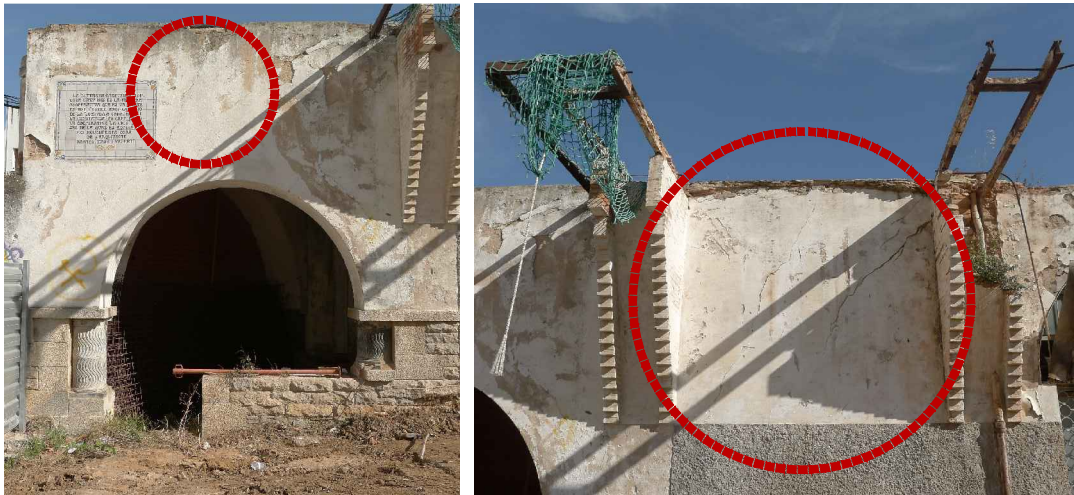
V01-02. Imatges de les esquerdes i fissures a la façana de ponent del teatre Odéon. Font: Arxiu GAA. Data: 14/02/2014.
