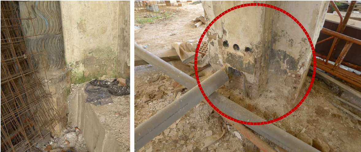
V08-09. Imatge de l'humitat retinguda a la base dels murs i pilars de l'àmbit de la porxada. Font: Arxiu GAA. Data: 14/02/2014.
