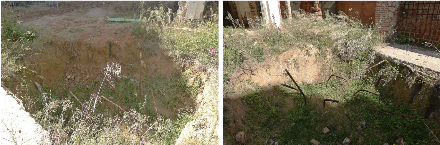
V06-07. Imatges de la fonamentació 33 sense executar. S'observen alguns armats sobresortint. Pendent de revisió de l'existència i/o estat de tensors i armat segons projecte. Font: Arxiu GAA. Data: 14/02/2014.
