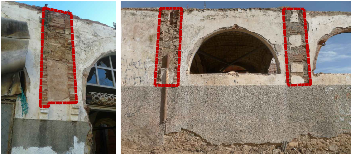
V03-04. Imatges dels elements ceràmics inexistent a la façana de ponent de l'edifici, anteriorment mènsules. Font: Arxiu GAA. Data: 14/02/2014.
