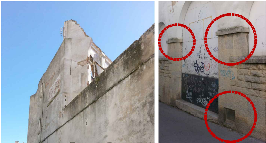
V06-07. Imatge de l'humitat retinguda i brutícia al mur de la façana de carrer Gram (Alçat de tramuntana), especialment a la part de l'ampit i al voltant dels elements sobresortints de planta baixa. Font: Arxiu GAA. Data: 14/02/2014.
