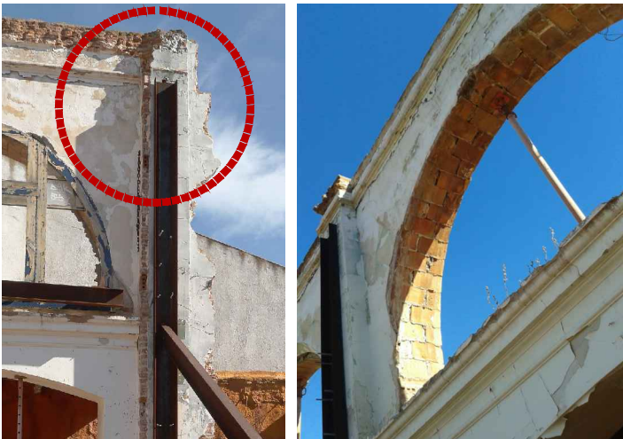
V08-09. Imatge d'elements inestables en el mur interior de ponent. Detall d'un arc amb disgregació de material. Font: Arxiu GAA. Data: 14/02/2014.
