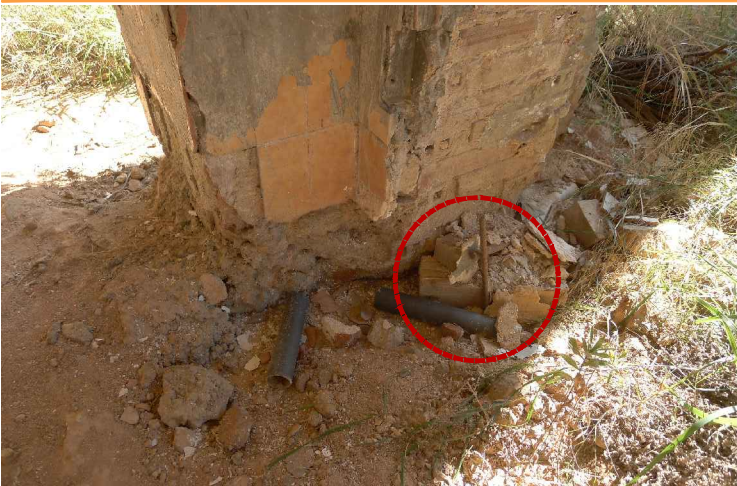
V15. Imatges de la base del pilar 20. S'observa algun armat dels micropilotis (sobresortint). Impossible observar l'existència o estat de la fonamentació existent. Font: Arxiu GAA. Data: 14/02/2014.
