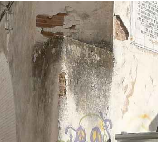
V08. Imatge de l'humitat retinguda al mur que fa cantonada al carrer Gram amb la plaça Colomer. Font: Arxiu GAA. Data: 14/02/2014.
