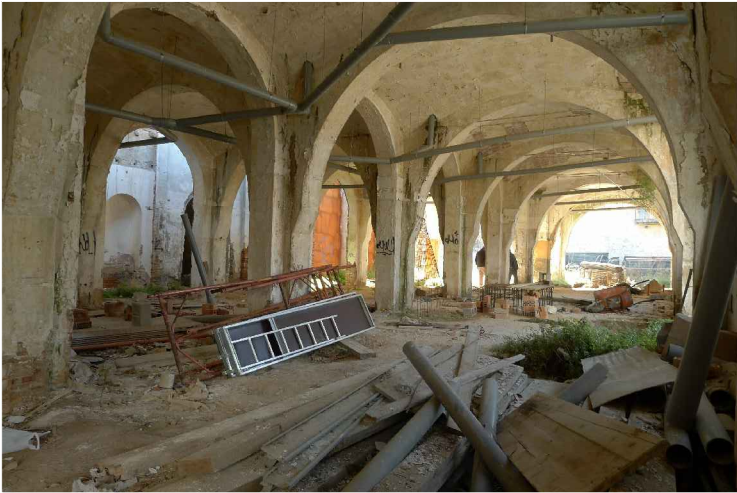
V01. Imatge global de l'interior. S'observen les voltes amb els baixants i col·lectors provisionals per evacuació de les aigües pluvials de coberta. Font: Arxiu GAA. Data: 14/02/2014.
