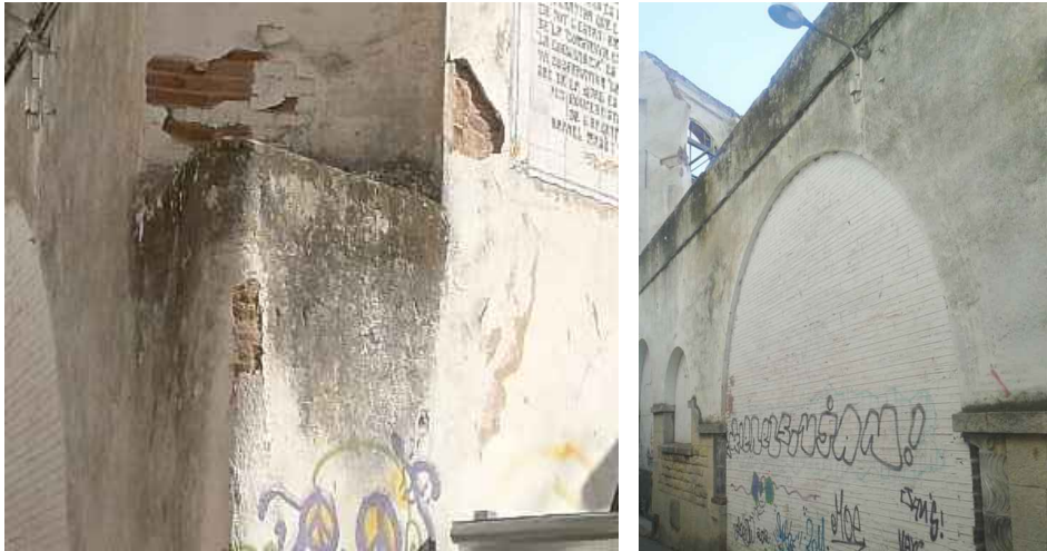
V07. Imatge de l'humitat retinguda al mur que fa cantonada al carrer Gram amb la plaça Colomer. Font: Arxiu GAA. Data: 14/02/2014. V08. Imatge de l'humitat retinguda a l'ampit de la façana de tramuntana. Font: Arxiu GAA. Data: 14/02/2014.
