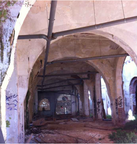
V15. Imatge dels canals i baixants de PVC per a l'evacuació provisional de les aigües pluvials. Font: Arxiu GAA. Data: 14/02/2014.
