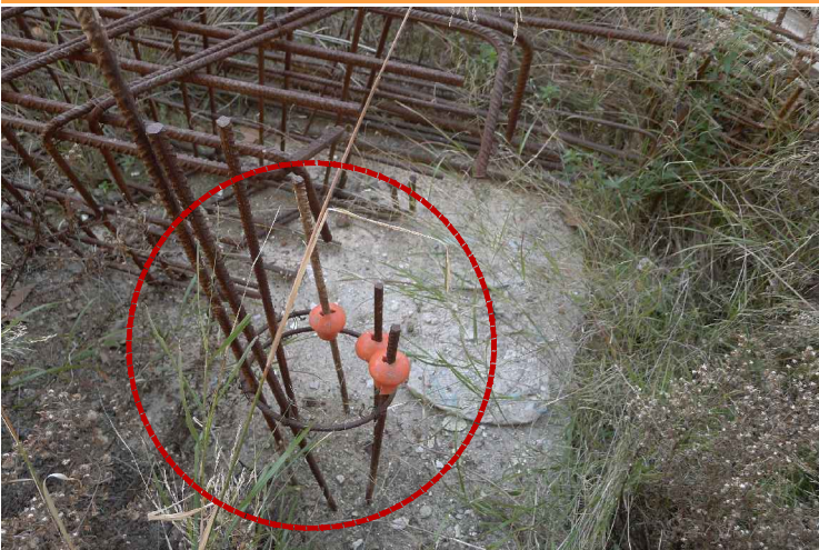
V19. Imatges de la fonamentació 23 executada, amb l'encepat ja formigonat. Es veu l'armat, sobresortint. Pendent de revisió de l'existència i/o estat de tensors i armat segons projecte. Font: Arxiu GAA. Data: 14/02/2014.
