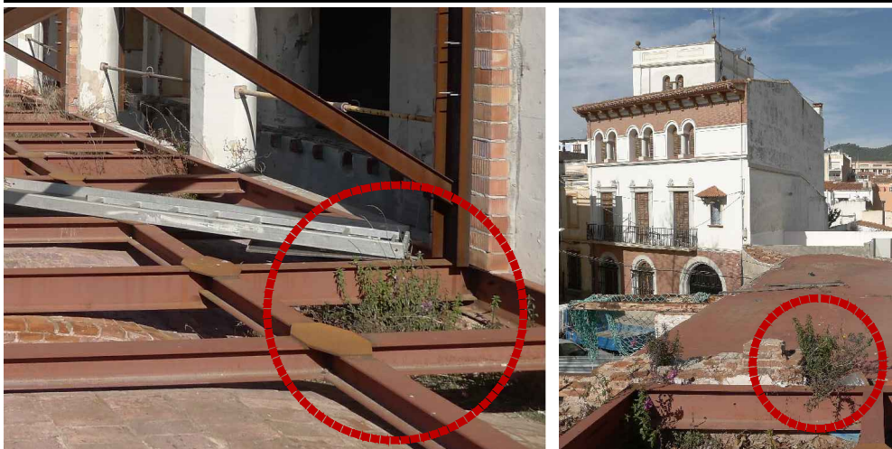
V13-14. Imatge de la vegetació en l'àmbit que cobreix la porxada (espai 2.2), especialment als ronyons de les voltes. Font: Arxiu GAA. Data: 14/02/2014.
