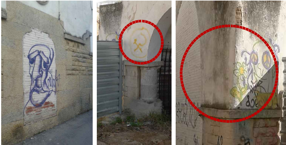
V05-06. Imatges de l'acció antròpica sobre els paraments de l'edifici. Detalls de la façana de tramuntana i part de la façana de ponent. Font: Arxiu GAA. Data: 14/02/2014.
