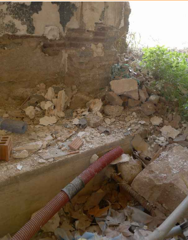
V09. Imatge de la fonamentació realitzada (F06). Impossible observar l'existència i/o estat dels tensors. Font: Arxiu GAA. Data: 14/02/2014.
