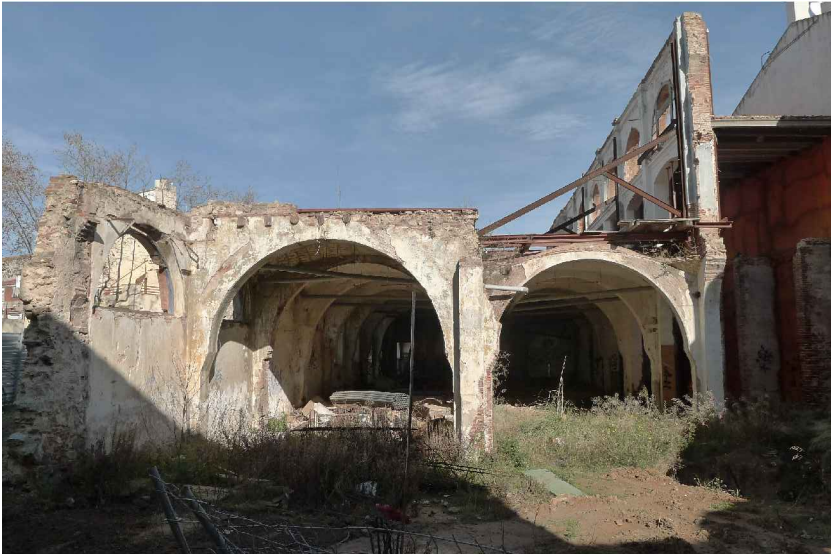
V01. Imatge de la façana sud del teatre Odèon. S'observa el mur de llevant apuntalat amb tornapunts. Font: Arxiu GAA. Data: 14/02/2014.
