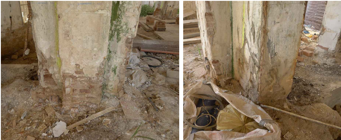
V03-04. Imatges de la base del pilar 14. Impossible observar l'existència i/o estat de la fonamentació existent. Font: Arxiu GAA. Data: 14/02/2014.
