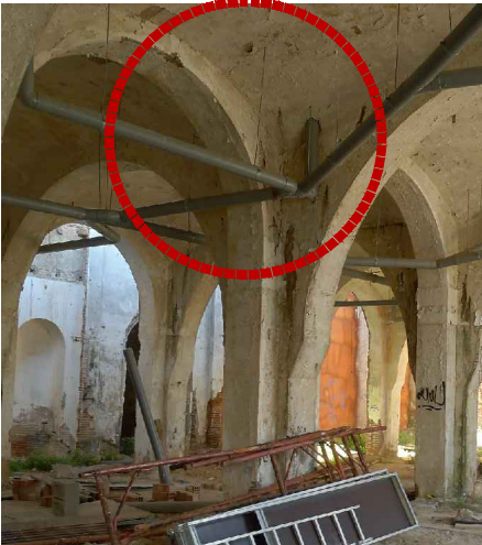
V16. Imatge dels canals i baixants de PVC per a l'evacuació provisional de les aigües pluvials. Font: Arxiu GAA. Data: 14/02/2014.
