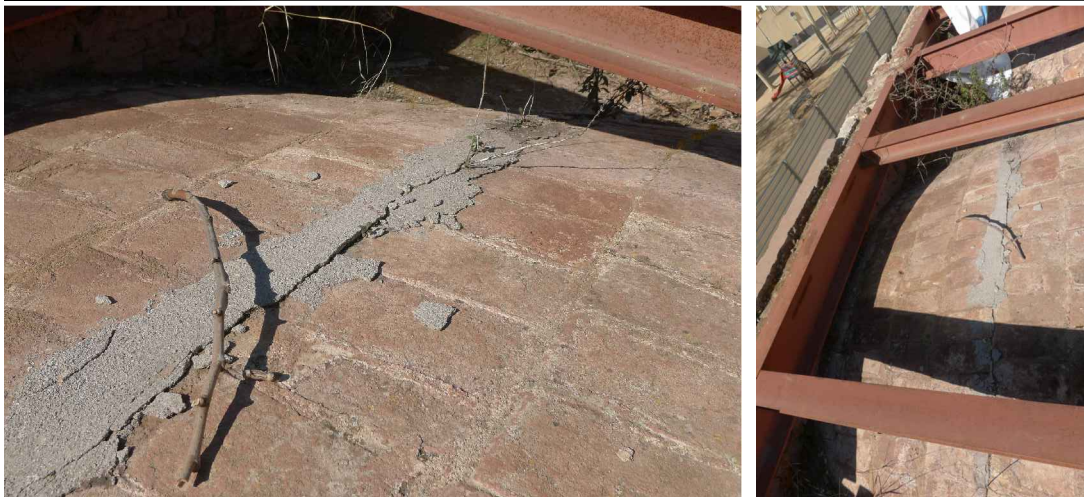
V01-02. Imatges de l'esquerda a l'extradós de les voltes de l'àmbit que cobreix la porxada (espai 2.2). S'observa que hi va haver una primera reparació disconforme, amb ciment Pòrtland. Font: Arxiu GAA. Data: 14/02/2014.
