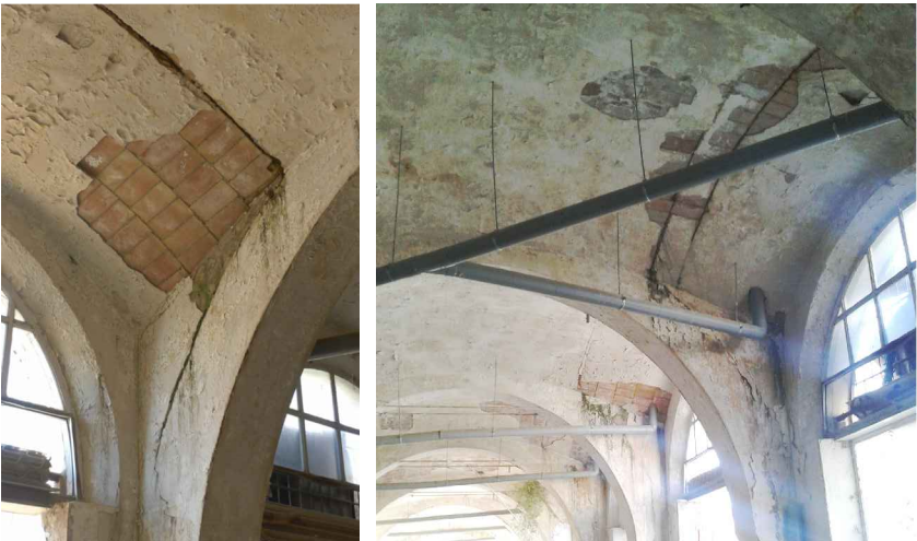
V01-02. Imatges de l'esquerda que travessa varies voltes de l'àmbit de la porxada. S'observa també la degradació dels revestiments d'aquestes voltes i dels junts de morter de calç. Font: Arxiu GAA. Data: 14/02/2014.
