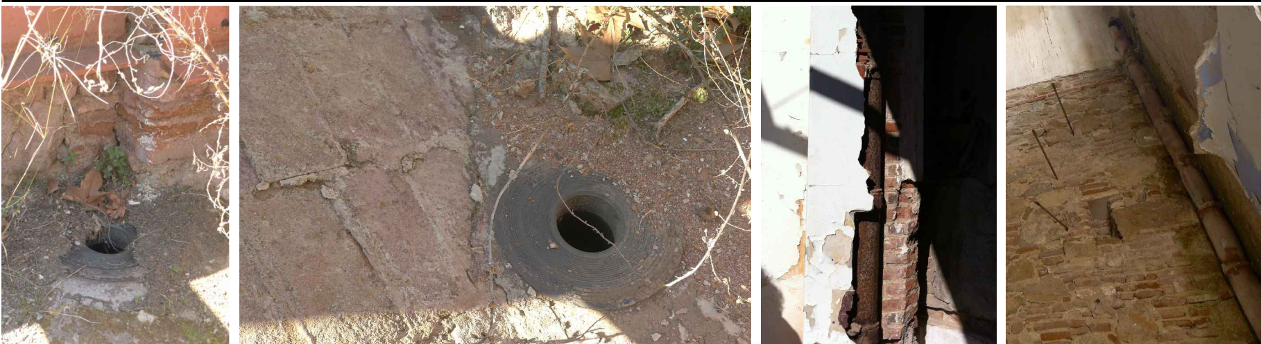
V15-16. Imatges de detall dels sobreixidors localitzats als ronyons de les voltes (espai 2.2). Font: Arxiu GAA. Data: 14/02/2014. V17-18. Imatges dels baixants i les instal·lacions obsoletes situades als espais 2.3 i 2.5, respectivament. Font: Arxiu GAA. Data: 14/02/2014.
